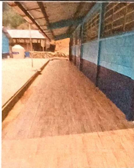
Foto 3: Elaboración de Cunetas para la protección del borde del entortado de cemento (Renglón Adicional). Al fondo tinaco de 2500 litros (adquirido como Renglón Adicional II)
